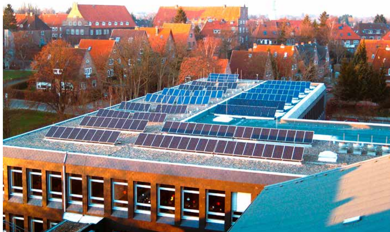
Das Solardach der Lornsenschule
